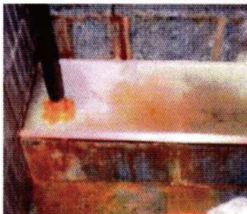
浴室内スケール
