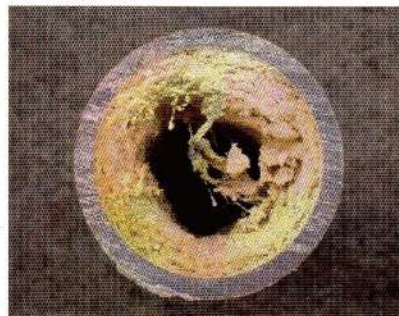
温泉配管内スケール (B)
